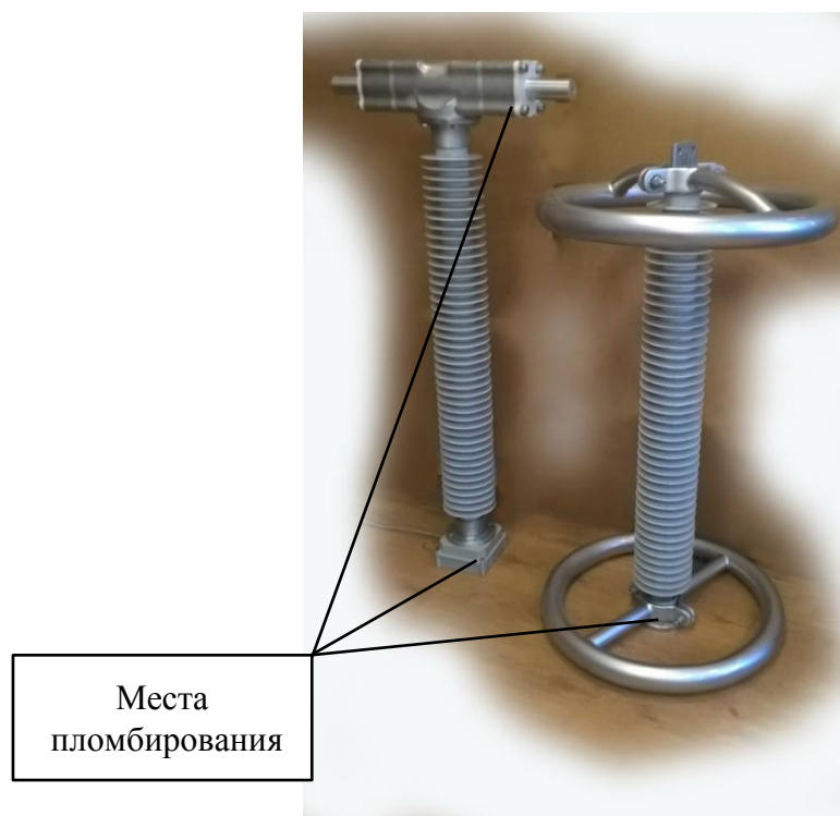
Рисунок 6 – Внешний вид исполнения ЦТТН 35 – 220 кВ в виде двух измерительных узлов силы тока и напряжения.
